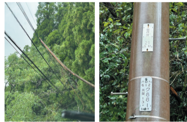
左は電線の様子。右は電柱番号の札。
